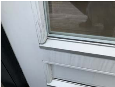
Det registreres utvendig avflassing av overflatebehandling.
