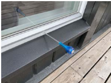
Det er påvist vinduer med fukt/råteskader.
