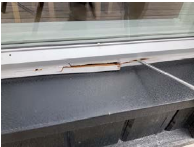
Det er påvist vinduer med fukt/råteskader.
