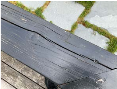
Stedvis sprekker i håndlist.
