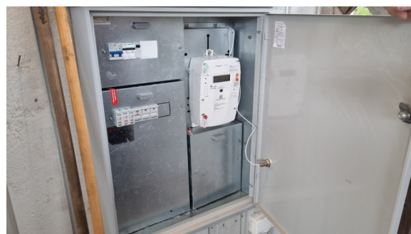
Utvendig skap med måler.
