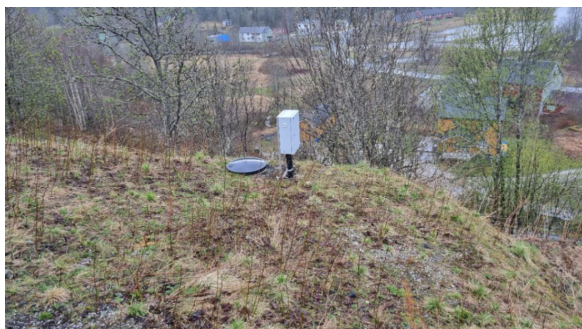
Boligen har septiktank med renseanlegg.
