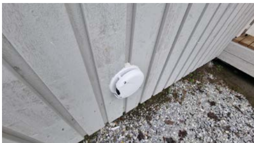
Ventil har skader
