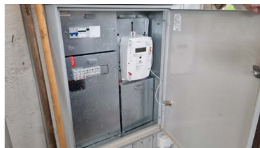
Utvendig skap med måler.
