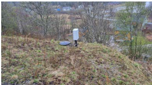
Boligen har septiktank med renseanlegg.
