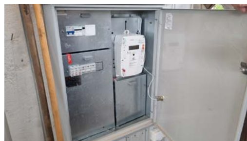
Utvendig skap med måler.
