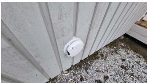
Ventil har skader
