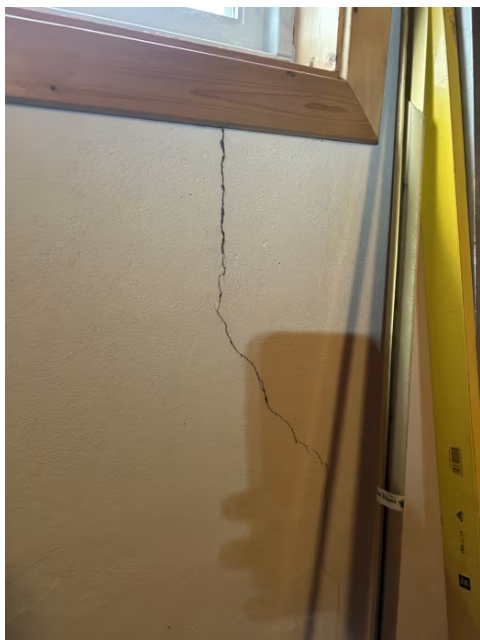
Sprekk i grunnmur
