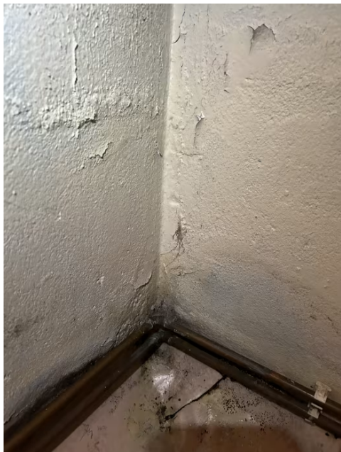
Kalk/saltutslag på vegger i kjeller.
