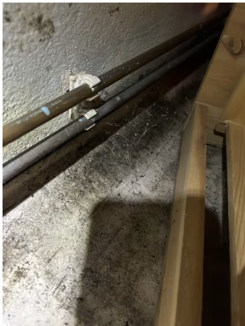
Sopp på vegg/gulv i kjeller.
