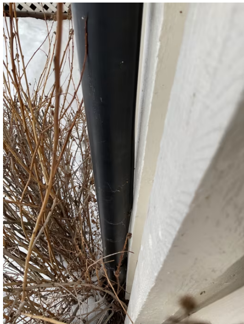
Frostspreg i nedløp.
