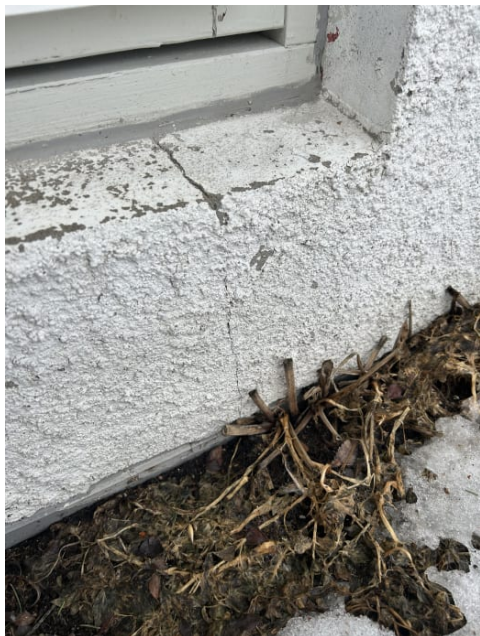
Sprekk i grunnmur.
