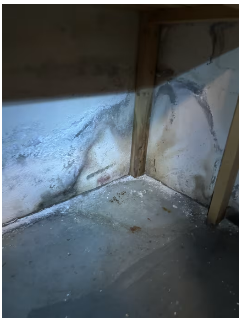
Kalk/saltutslag på vegger i kjeller.
