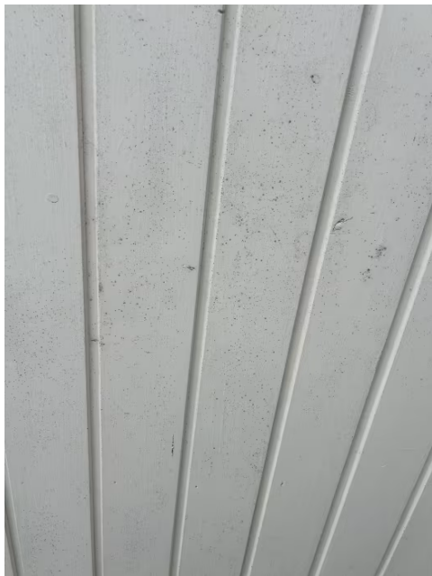
Svertesopp på utvendig kledning.
