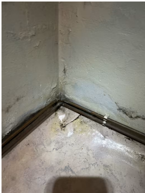
Kalk/saltutslag på vegger i kjeller.
