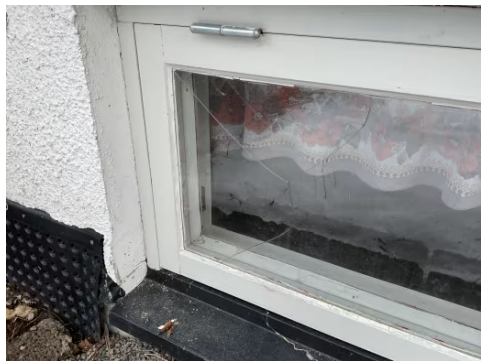
Sprekk i vindu på vaskerom.
