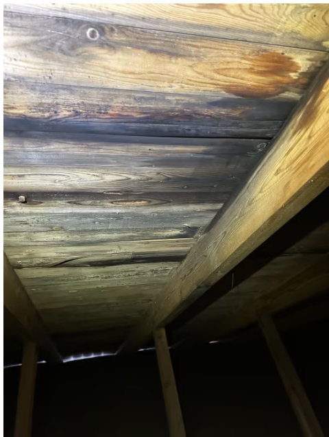
Råteskader i undertaket.
