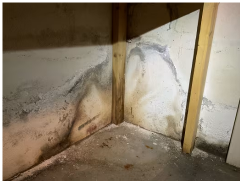
Salt/kalkutslag i kjeller.
