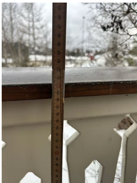
Høyde på rekkverk.
