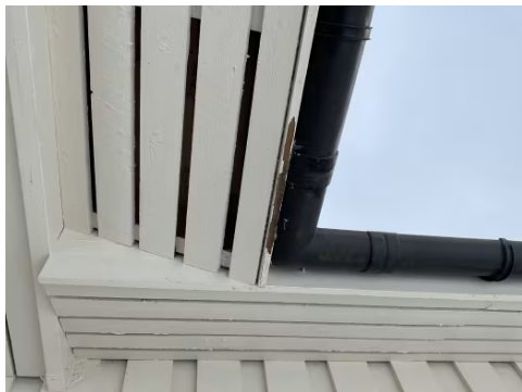
Fukt/råteskade ved inngangsparti.
