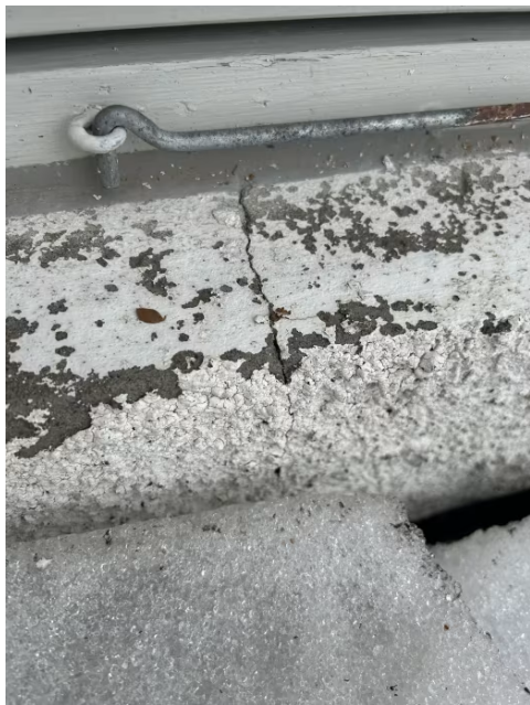
Sprekk i grunnmur.
