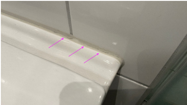
Sprukket silikonfuge som følge av løs toalettskål.
