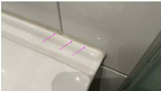
Sprukket silikonfuge som følge av løs toalettskål.
