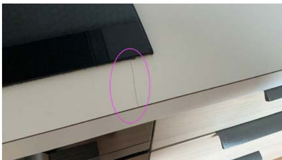
Liten sprekk i benkeplate.
