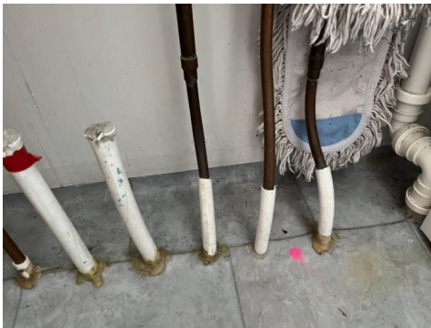
Sprekk i belegg ved rørgjennomføringer.
