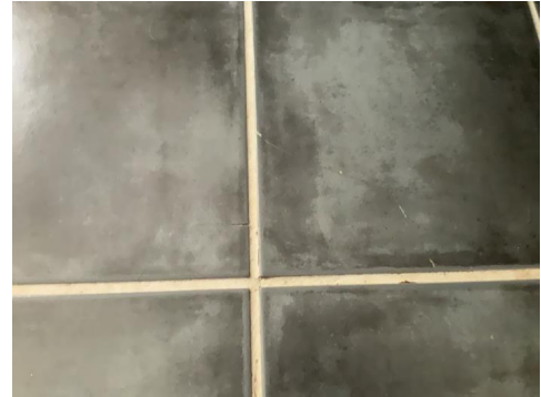
Sprukket flis, sprekker i fuger.
