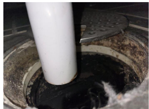
Sluk under kabinett. Løs klemring.
