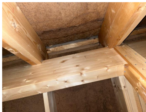
Fuktskjolder i undertak.
