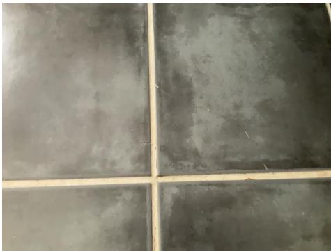
Sprukket flis, sprekker i fuger.
