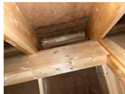
Fuktskjolder i undertak.
