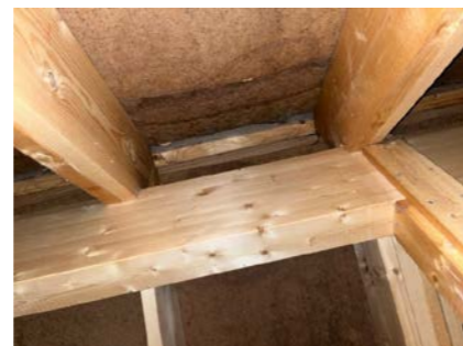
Fuktskjolder i undertak.
