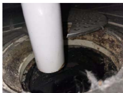
Sluk under kabinett.
