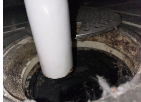
Sluk under kabinett.
