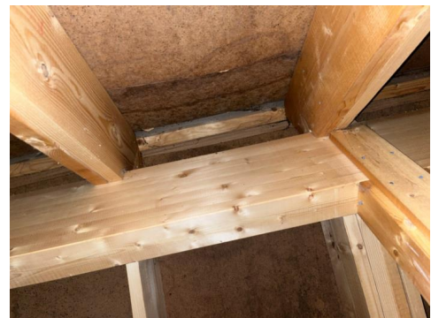
Fuktskjolder i undertak.
