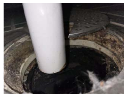
Sluk under kabinett.
