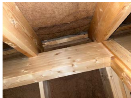
Fuktskjolder i undertak.
