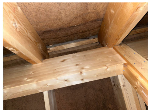
Fuktskjolder i undertak.
