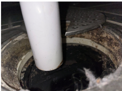
Sluk under kabinett.
