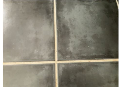
Sprukket flis, sprekker i fuger.
