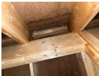
Fuktskjolder i undertak.
