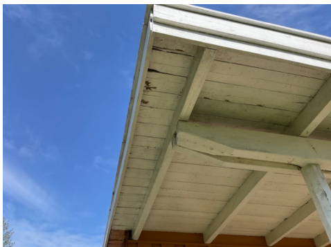
Undertak med vedlikeholdsbehov
