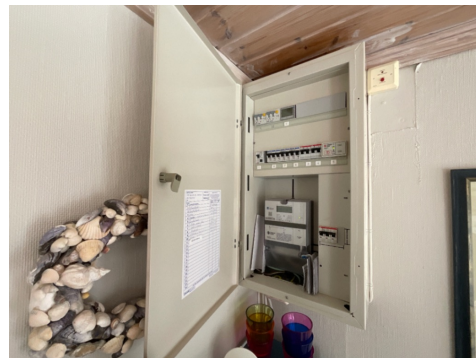
Sikringsskap i stue
