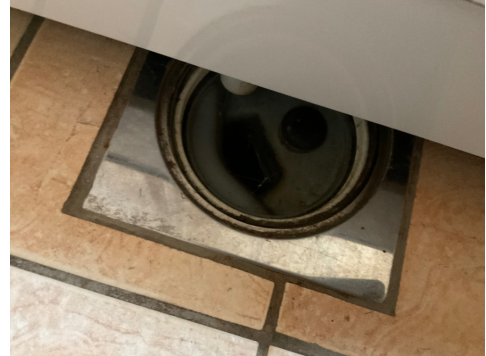
Sluk under dusjkabinett
