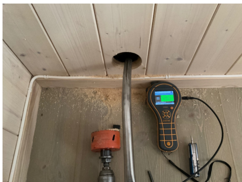
Hulltaking fra soverom
