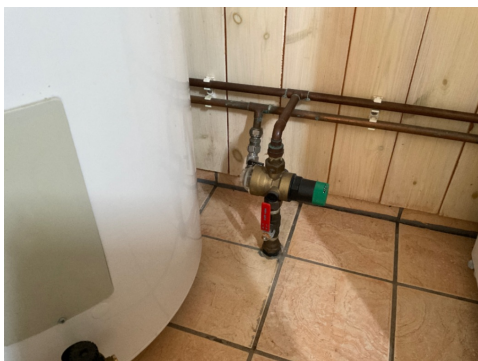
Kobberrør på vegg og stoppekran
