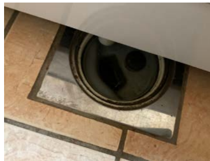
Sluk under dusjkabinett
