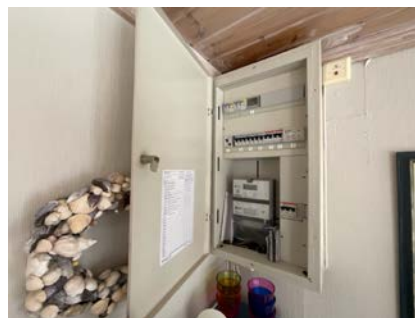
Sikringsskap i stue
