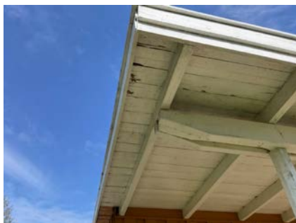
Undertak med vedlikeholdsbehov
