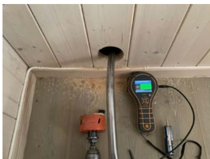
Hulltaking fra soverom
