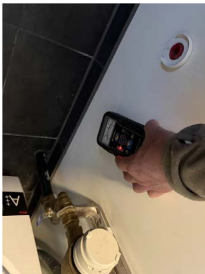
Ingen fukt, kapsel drener uttak fra samleskap mangler.
