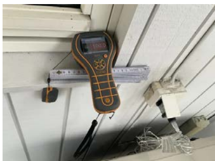
Fukt i karm, områder under beslag mest utsatt.
