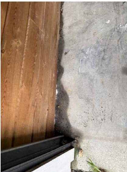
Fuktsamling ved inngang port.
