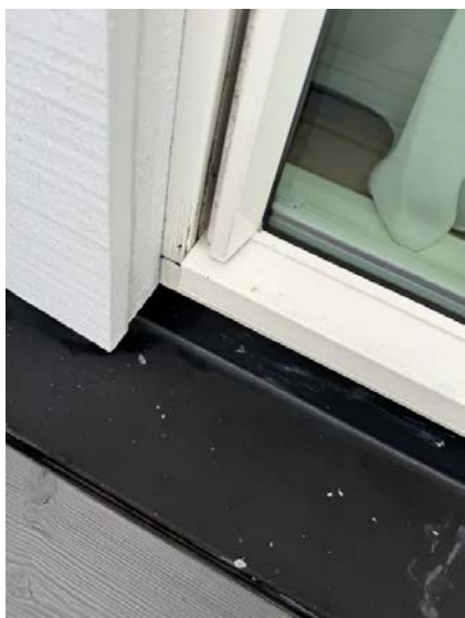
Løse karmister vinduer stue ved balkong.
