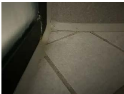
Mindre riss/sprekke i silikonfuger.
