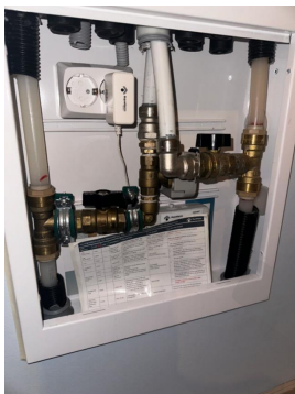
Samleskap med stoppekraner plassert på soverom
