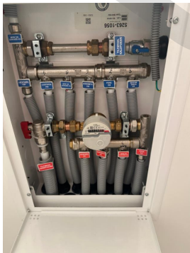
Samleskap med rørkurser og stoppekraner på bad
