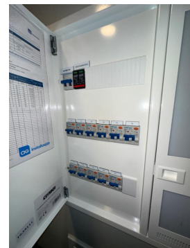
Sikringsskap med automatsikringer.
