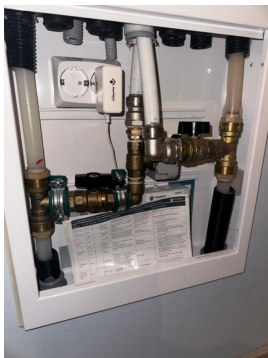
Samleskap med stoppekraner plassert på soverom
