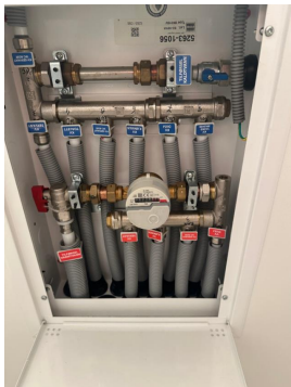
Samleskap med rørkurser og stoppekraner på bad
