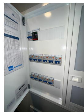
Sikringsskap med automatsikringer.
