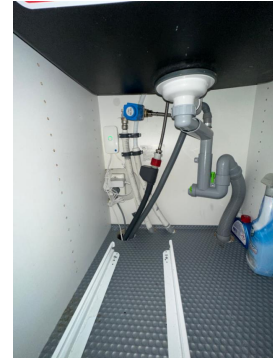
Røropplegg i kjøkkenbenk med Waterguard
