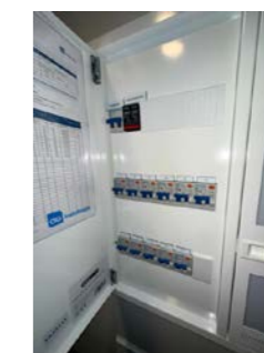
Sikringskap med automatsikringer.
