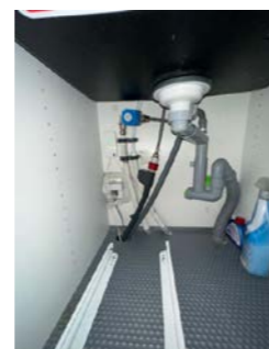
Røropplegg i kjøkkenbenk med Waterguard
