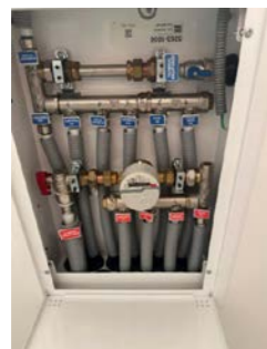
Samleskap med rørkurser og stoppekraner på bad
