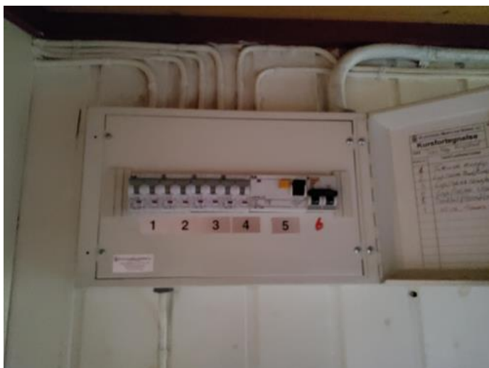
Elektrisk anlegg - [Sikringsskap]
