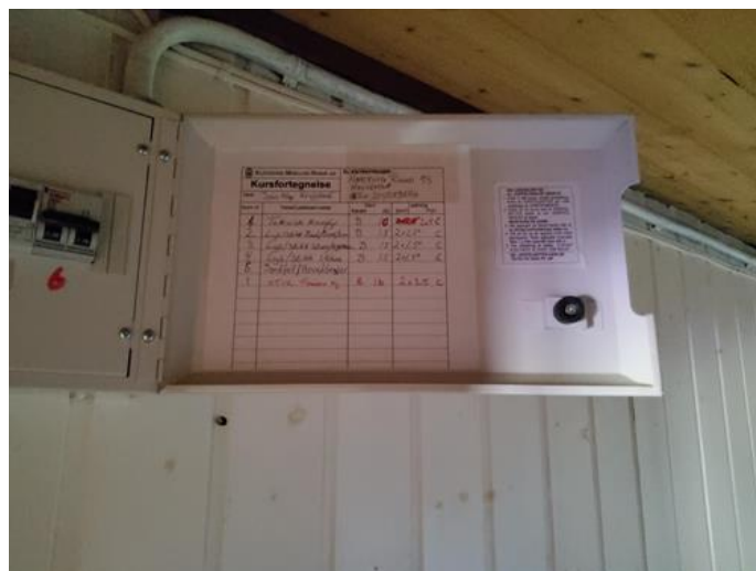
Elektrisk anlegg - [Kursfortegnelse]
