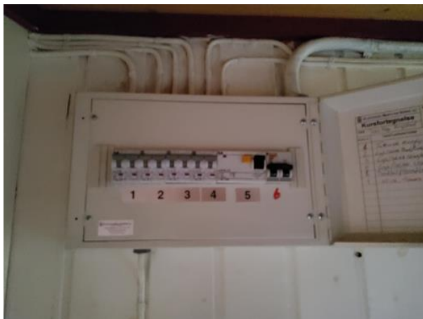
Elektrisk anlegg - [Sikringsskap ]
