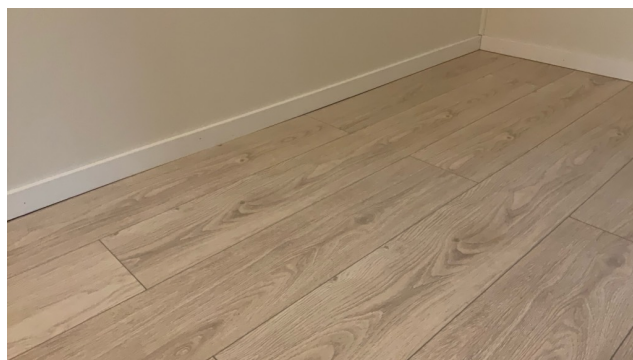
Åpninger mellom gulv og gulvlist.
