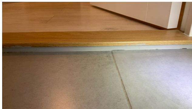
Sprekk i silikonering mot dørterskel.
