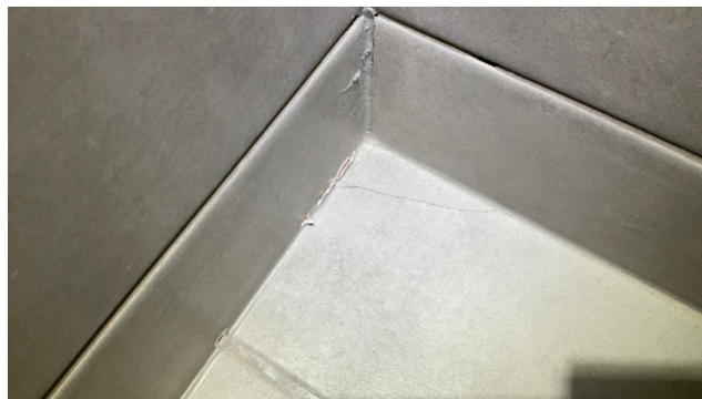
Sprekk i gulvflis.
