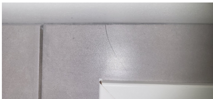
Sprukket flis over dør
