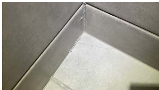
Sprekk i gulvflis.
