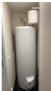
Bereder plassert på teknisk rom.
