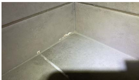
Skade på sokkelflis nede ved gulv.
