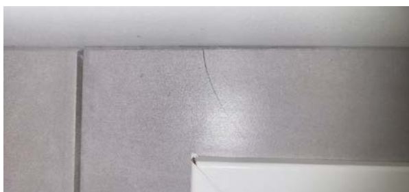
Sprukket flis over dør
