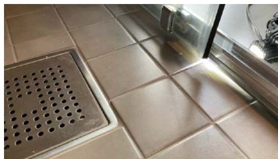
For liten åpning under sokkel for evt. lekkasjevann
