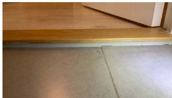
Sprekk i silikonering mot dørterskel.
