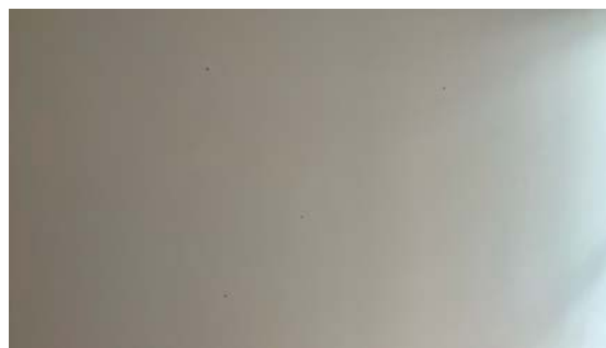
Skruehull i vegger
