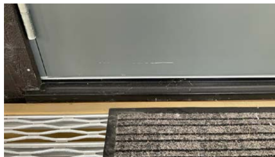
Skade i overflate på inngangsdør.
