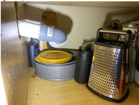
Rør fra kjøkken ført ut i skapet.
