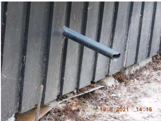
Rør for gråvann, tatt i forbindelse med skadesak i 2021.
