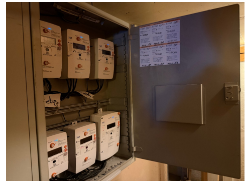
Felles målerskap i u-etg
