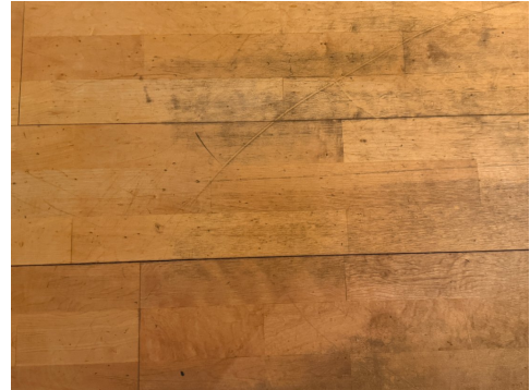
Slitasje/striper i parkettgulv i entre/gang.
