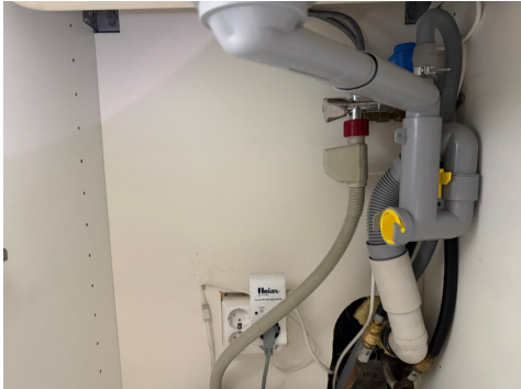
Røropplegg og aquastop under vask.
