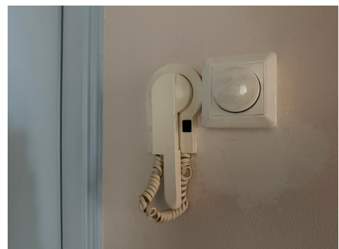
Dørtelefon i entre/gang.
