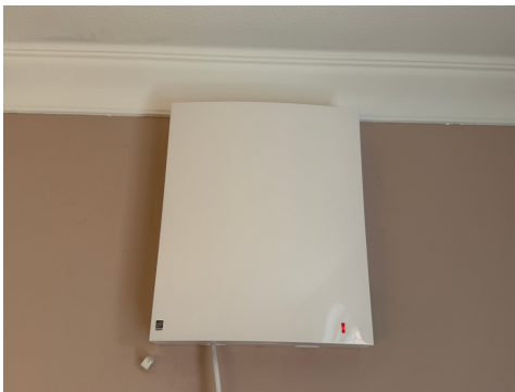
Flexit romventilasjon i stue.
