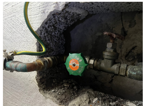
Felles stoppekran i u-etg.
