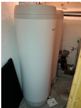
Felles varmtvannstanker i u-etg.
