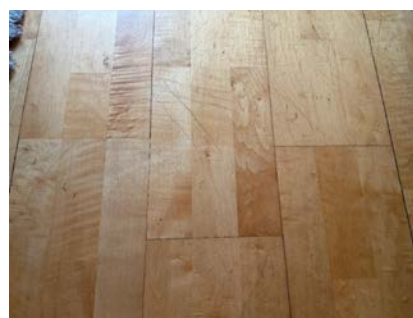
Slitasje/striper i parkettgulv i stue.
