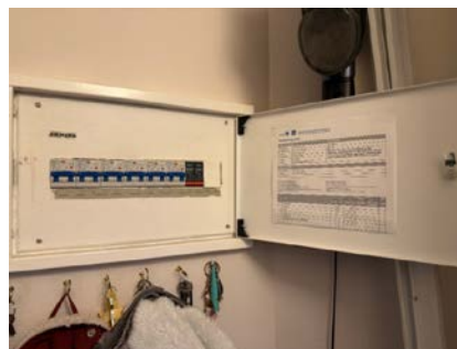
Sikringskap i entre/gang.
