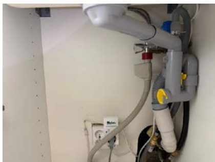
Rørropplegg og aquastop under vask.
