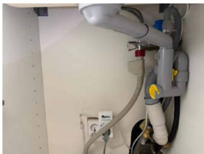
Rørropplegg og aquastop under vask.
