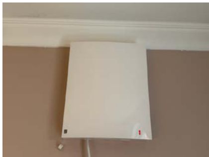
Flexit romventilasjon i stue.
