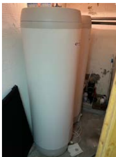
Felles varmtvannstanker i u-etg.
