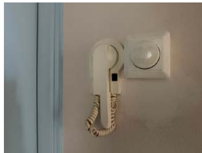
Dørtelefon i entre/gang.
