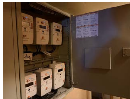
Felles målerskap i u-etg
