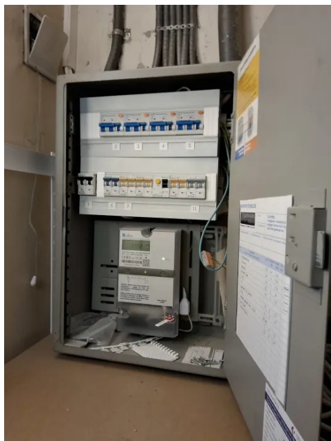
Sikringsskap er plassert i vindfang.
