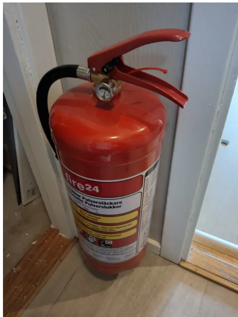
Vegghengt brannslukningsapparat i vindfang.
