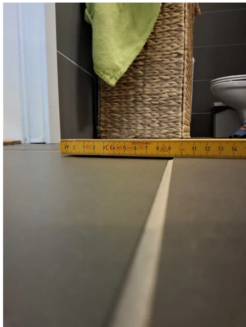
Trapping mellom gulvfliser.
