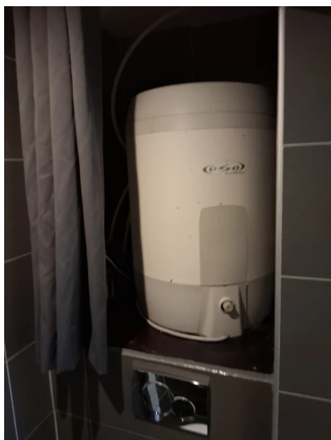
Varmtvannsbereder er plassert i nisje bak toalett på bad.
