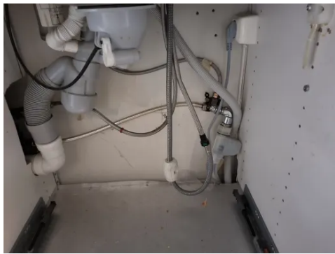
Synlige avløpsrør av plast i leiligheten.
