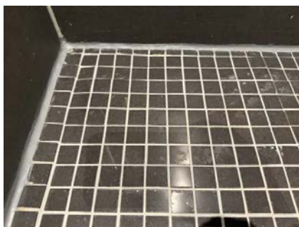
Ujevne mosaikkfliser på gulv i dusjnisje.
