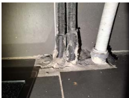
Det kan ikke verifiseres at rørgjennomføringer i gulv er forskriftsmessig utført.
