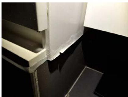
Svelleskader på høyskap.
