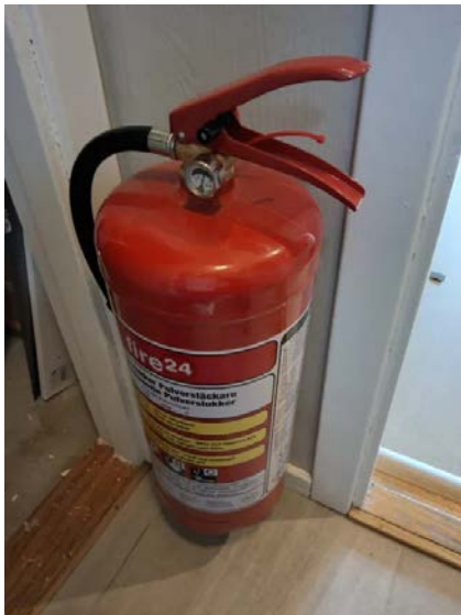
Vegghengt brannslukningsapparat i vindfang.
