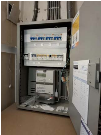
Sikringsskap er plassert i vindfang.
