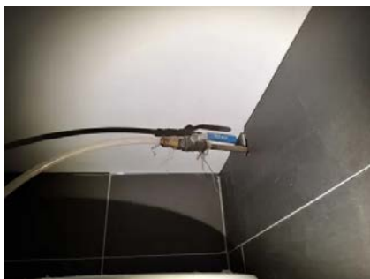
Hovedstoppekran er plassert på bad.
