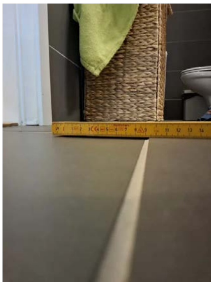
Trapping mellom gulvfliser.
