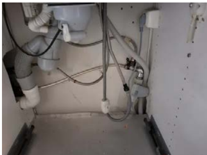
Synlige avløpsrør av plast i leiligheten.
