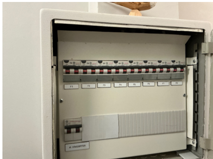
Automatsikringer i sikringsskap plassert i gang.
