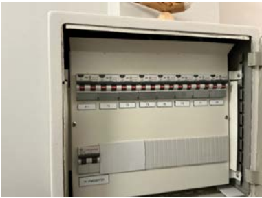
Automatsikringer i sikringsskap plassert i gang.
