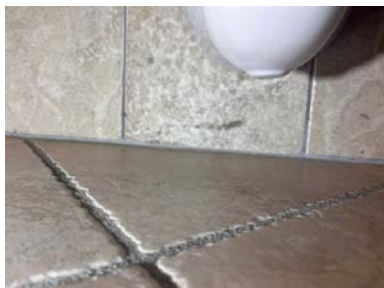
Ingen dreinsåpning under den innebygde vannsisternen
