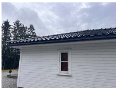
Mangler snøfangere på hele taket
