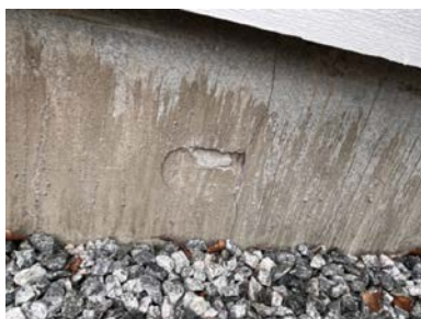
Skade på plate utenpå mur.
