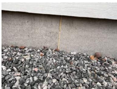
Mangler fuge i skjøter.
