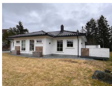
Mangler snøfangere på hele taket
