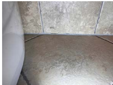
Sprekk i fuge i våtsone.
