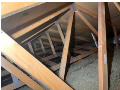
Vanskelig tilgang til kaldloft.
