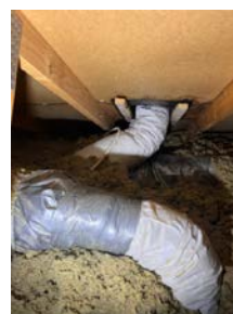
Fuktmerker i forbindelse med takgjennomføringen.
