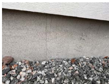
Små sprekker på utside av mur.
