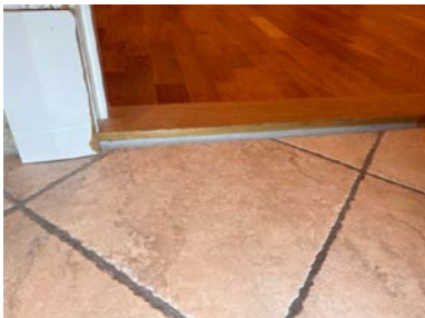
Oppkant under dør ca 10mm
