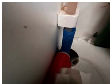
Ikke montert tettemuffer i varerør.
