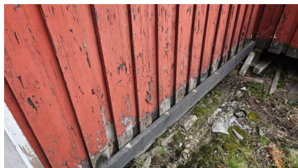
Værslitt/påbegynte råteskader i kledning
