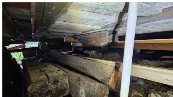
Understøttende jernbanesviller har falt ned.
