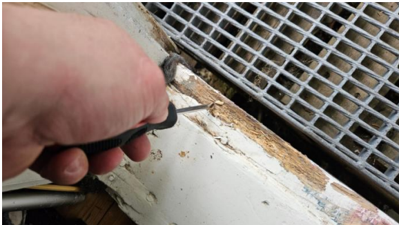
Råte i dørterskel.
