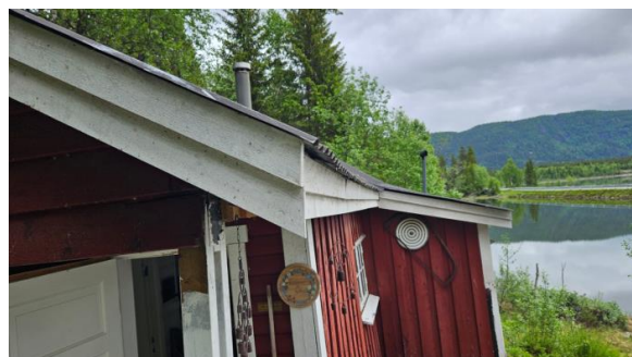
Skjevheter i takkonstruksjonen.
