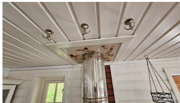
Rustdannelse på beslag i himling.
