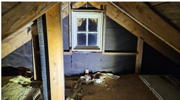
Bør etableres inspeksjons mulighet til tilbygddel.
