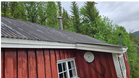
Det er ikke montert takrenne og nedløp.
