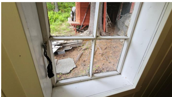
Sprukket glass i vindu i entre.
