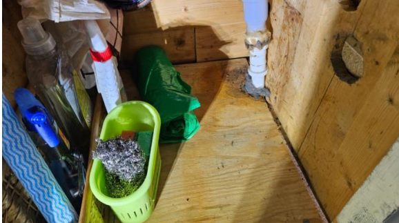
Kontroll av røropplegg, spor av mus.
