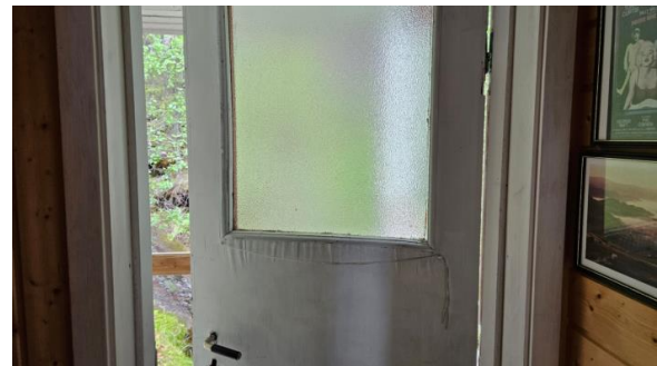
Fuktsvell i dør (bakside).
