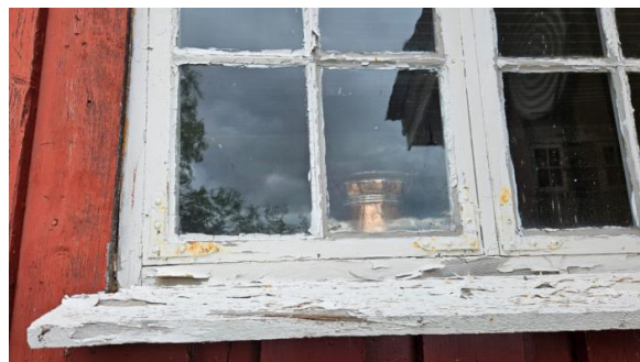
Påbegynte råteskader i vindu.
