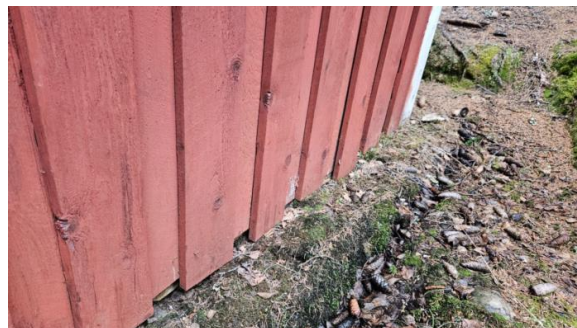
Manglende bortledning av vann fra tak.
