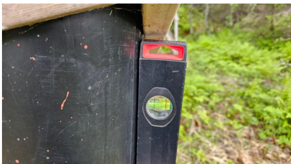
Skjevheter i pilarer.
