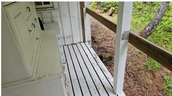
Manglende rekkverk på baksiden.
