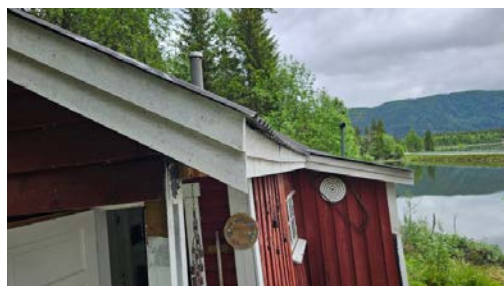
Skjevheter i takkonstruksjonen.
