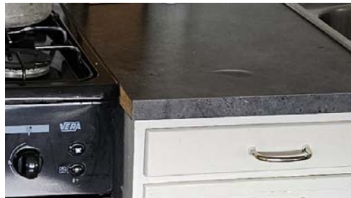
Mangler kant laminering på benkeplate og boble i benkeplate.
