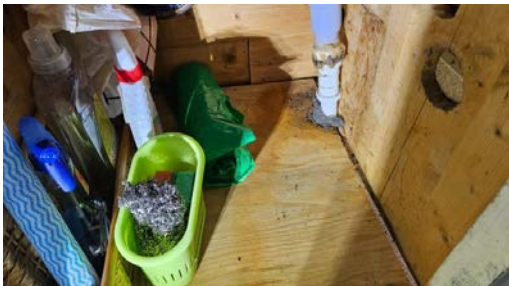
Kontroll av røropplegg, spor av mus.
