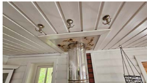
Rustdannelse på beslag i himling.
