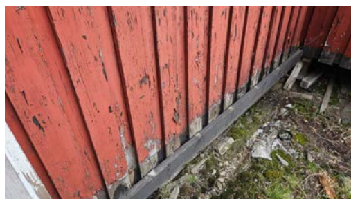
Værslitt/påbegynte råteskader i kledning
