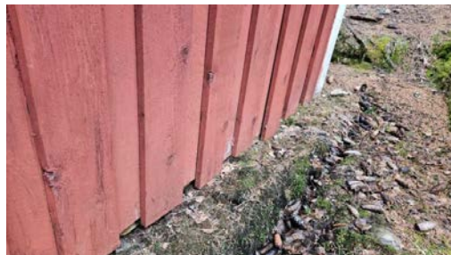
Manglende bortledning av vann fra tak.
