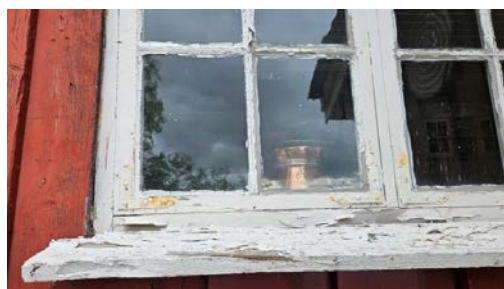
Påbegynte råteskader i vindu.
