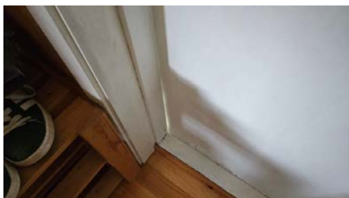
Dør tetter ikke mot karm (hoveddør),
