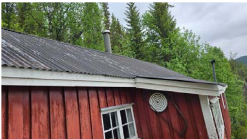
Det er ikke montert takrenne og nedløp.
