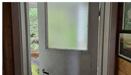
Fuktsvell i dør (bakside).
