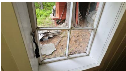
Sprukket glass i vindu i entre.
