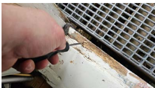
Råte i dørterskel.
