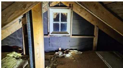
Bør etableres inspeksjons mulighet til tilbygddel.
