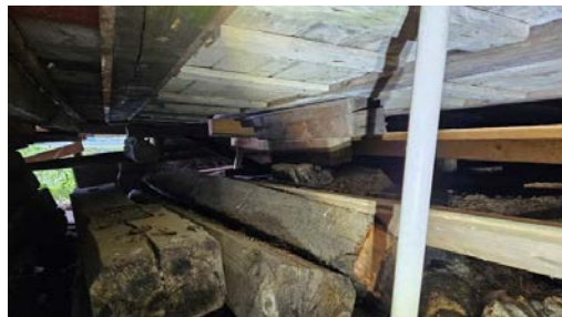
Understøttende jernbanesviller har falt ned.
