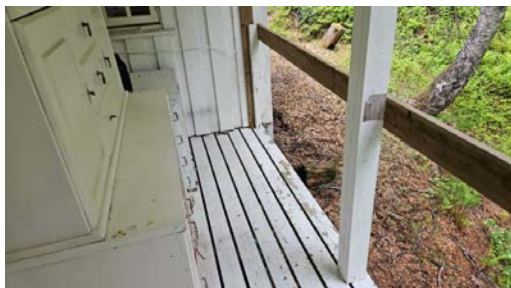
Manglende rekkverk på baksiden.
