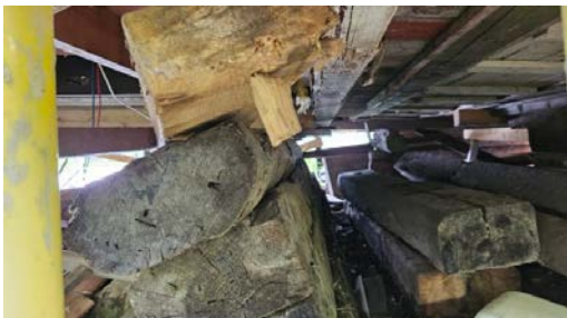
Skjevheter i understøttende jernbanesviller.
