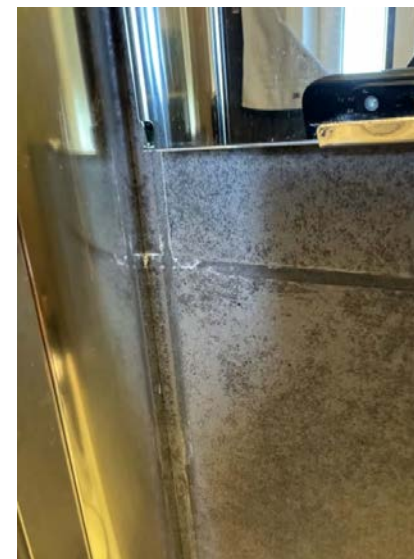
Mindre kalkutslag og normal slitasje.
