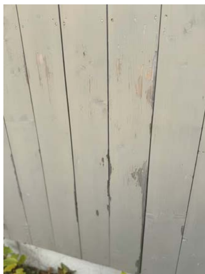
Det er behov for noe overflatebehandling.
