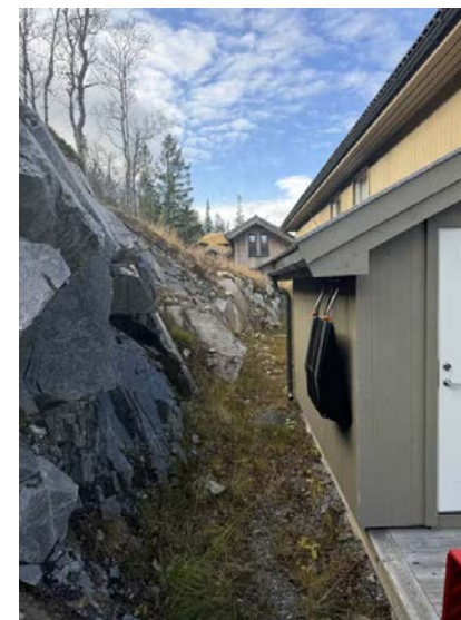
Noe vann vil renne ned fra fjell, men blir drenert bort av masser ved grunnmur. Ingen synlig fuktopptrekk på mur.
