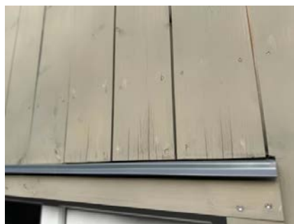
Soltørket og oppsprukket panel.
