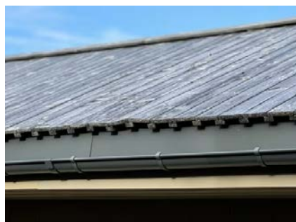
Bordtak har ujevnheter som trenger vedlikehold.
