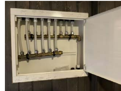
Vannlåsskap i bod.
