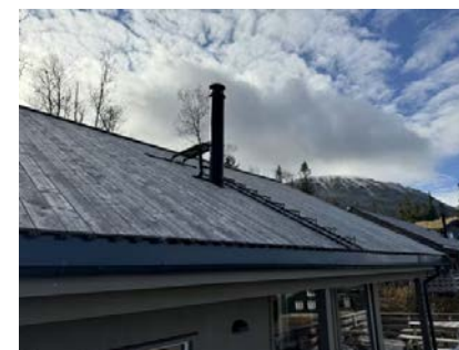
Taket har stige og plattform til pipe, men ingen snøfangere som var et krav på byggetidspunktet.
