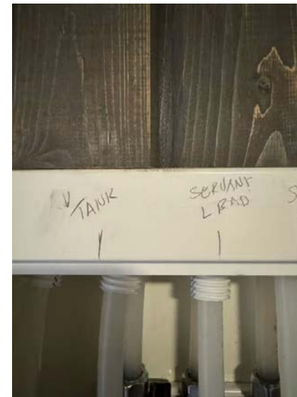
Det er ikke noen kursoversikt i vannlåsskap, men merket direkte på skap.
