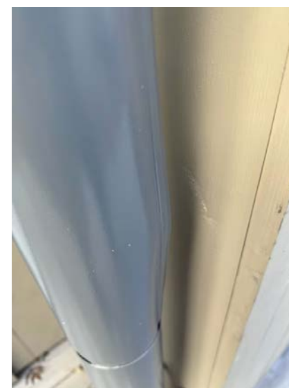
Frostsprengning på nedløpsrør.
