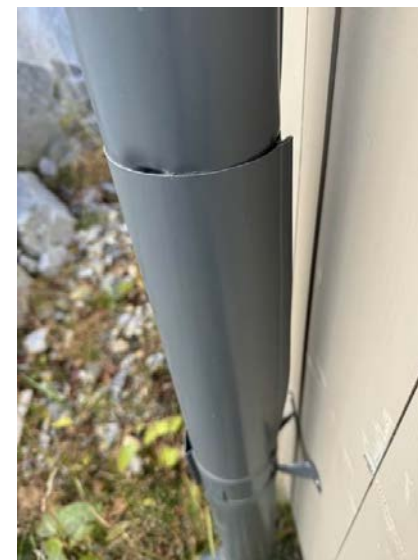
Frostsprengning på nedløpsrør.
