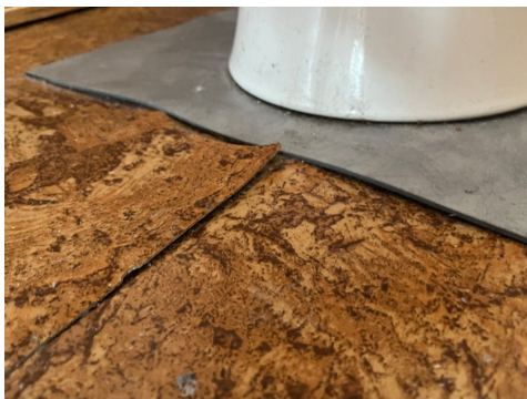
Vinyfliser har løsnet.
