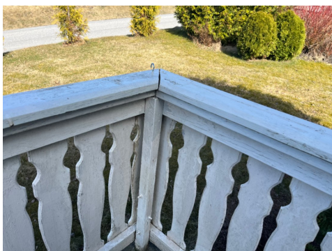
Rekkverk bør utbedres og behandles.
