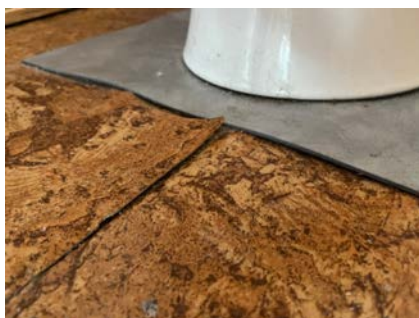
Vinyfliser har løsnet.
