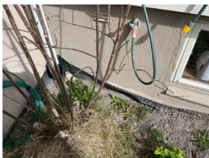
Manglende tetningslist på grunnmursplast.
