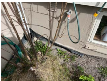
Manglende tetningslist på grunnmursplast.
