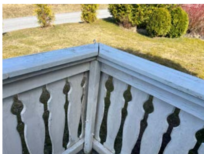
Rekkverk bør utbedres og behandles.
