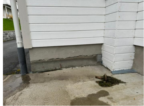
Sprekkdannelser på grunnmuren til krypekjelleren.
