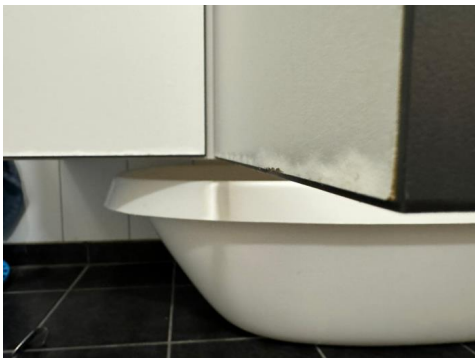
Fuktskader på innredningen.
