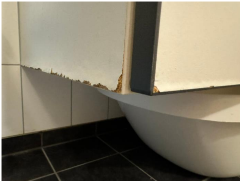
Fuktskader på innredningen.
