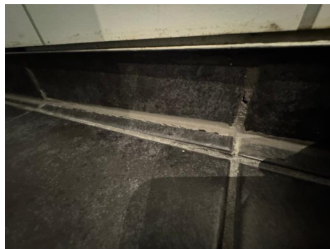
Manglende fuge i nedkanten av baderomsplatene.
