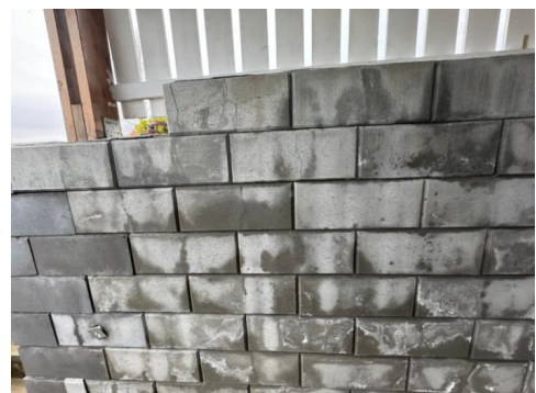
Eksempel på riss og sprekker i forstøtningsmurer.
