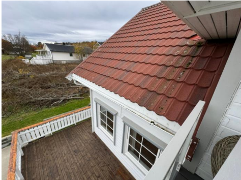
Manglende snøfanger hvor folk kan ferdes.
