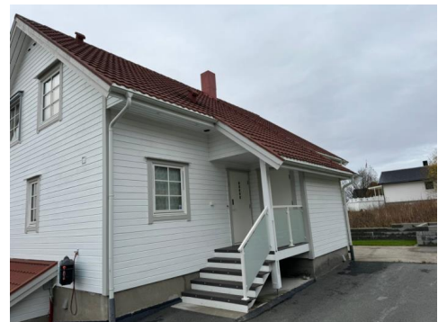
Manglende snøfanger hvor folk kan ferdes.
