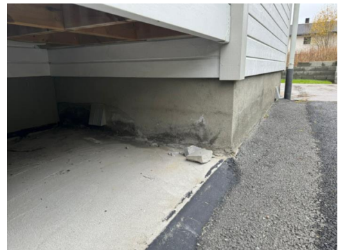
Krypekjeller under utvendig bod.
