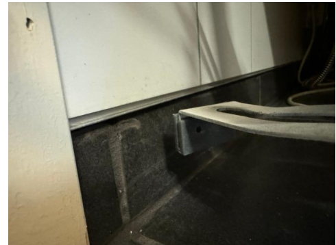
Manglende fuge i nedkanten av platene.
