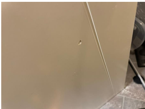
Skade i innvendig dør.
