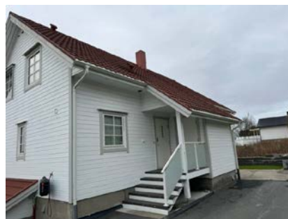
Manglende snøfanger hvor folk kan ferdes.
