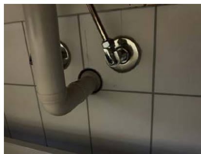
Rørgjennomføring som ikke er fuget.
