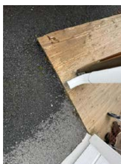
Ikke tilfredsstillende bortledning av vann.
