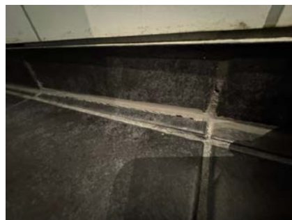
Manglende fuge i nedkanten av baderomsplaten.
