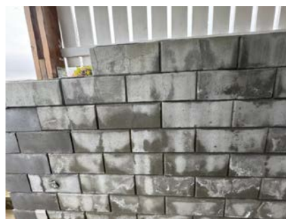
Eksempel på riss og sprekker i forstøtningsmurer.
