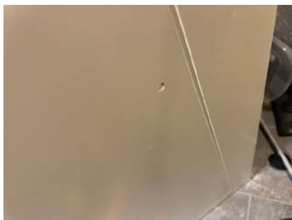
Skade i innvendig dør.
