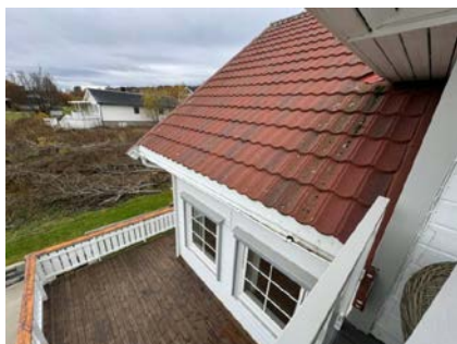
Manglende snøfanger hvor folk kan ferdes.
