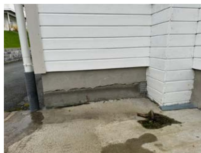
Sprekkdannelse på grunnmuren til krypekjelleren.
