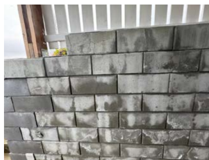
Eksempel på riss og sprekker i forstøtningsmurer.
