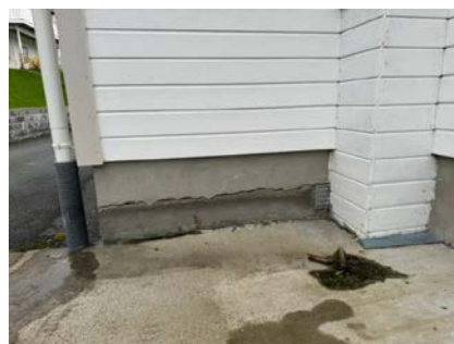
Sprekkdannelser på grunnmuren til krypekjelleren.
