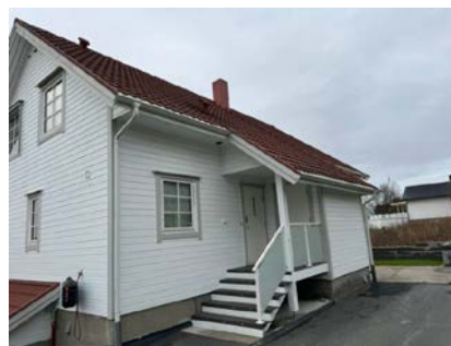
Manglende snøfanger hvor folk kan ferdes.
