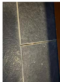
Eksempel på skade på gulvet ved kjøkkenet.
