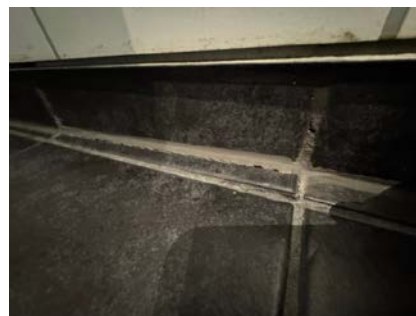
Manglende fuge i nedkanten av baderomsplatene.
