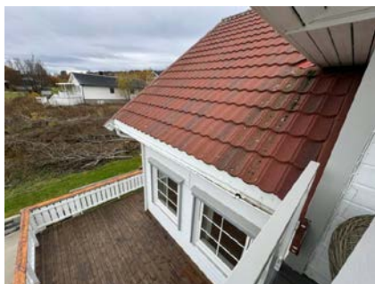
Manglende snøfanger hvor folk kan ferdes.
