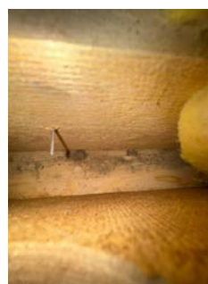
Innvendig i veggen hvor fuktmålingen er foretatt.
