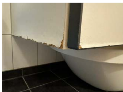
Fuktskader på innredningen.
