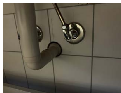
Rørgjennomføring som ikke er fuget.
