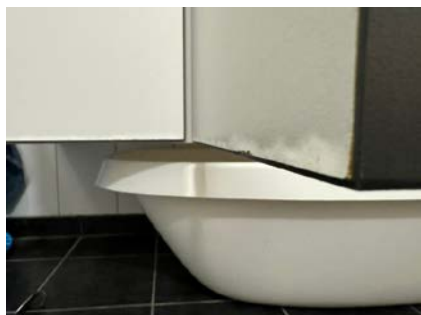
Fuktskader på innredningen.
