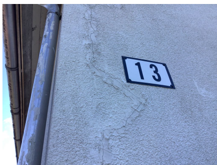
Eksempel på sprukket puss.
