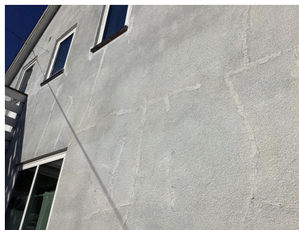
Eksempel på sprukket puss.
