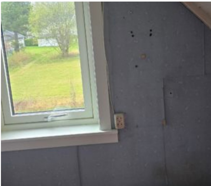
Bilde 3 Løs ledning
