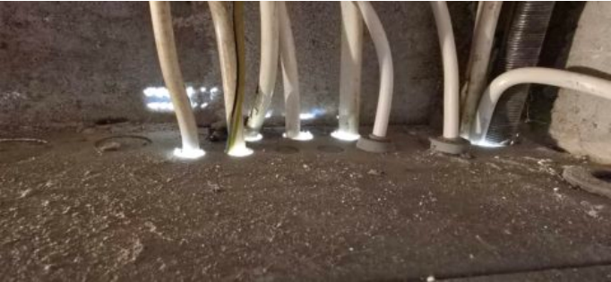
Bilde 1 Hull i tavle må merkes.
