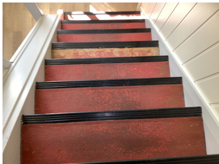
Slitasje på gulvbelegg i trinn.
