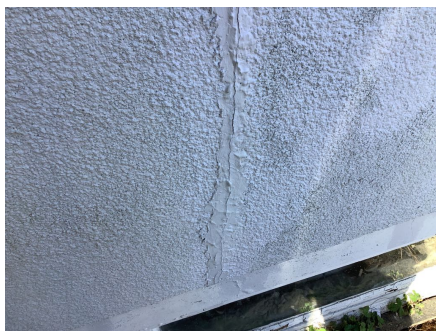
Eksempel på sprukket puss.
