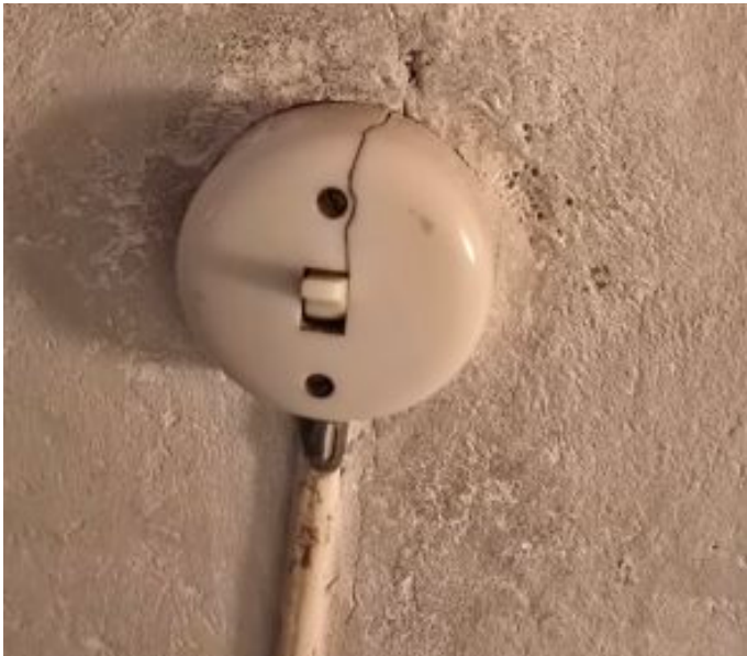
Bilde 1 Bryter defekt i trappenedgang. Bør byttes.
