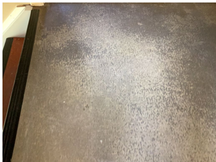
Slitasje på gulvbelegg.
