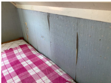
Løsnet tapet på soverom.
