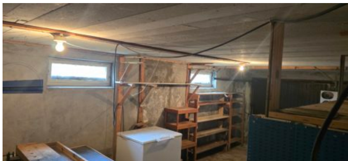
Bilde 1 Mangler kuppler i det meste av kjeller .
