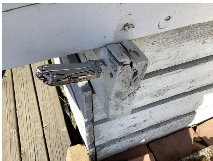
Råteskadet bærebjelke i første etasje.
