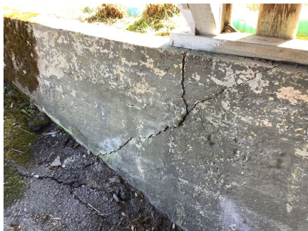
Eksempel på sprekk i støpt vange.
