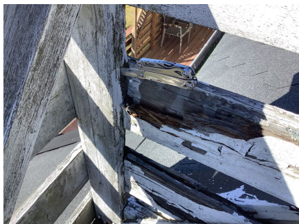
Råteskadet rekkverksstolpe og rekkverksbord på takterrasse.
