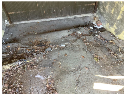
Ujevn asfalt med sprekkdannelser.
