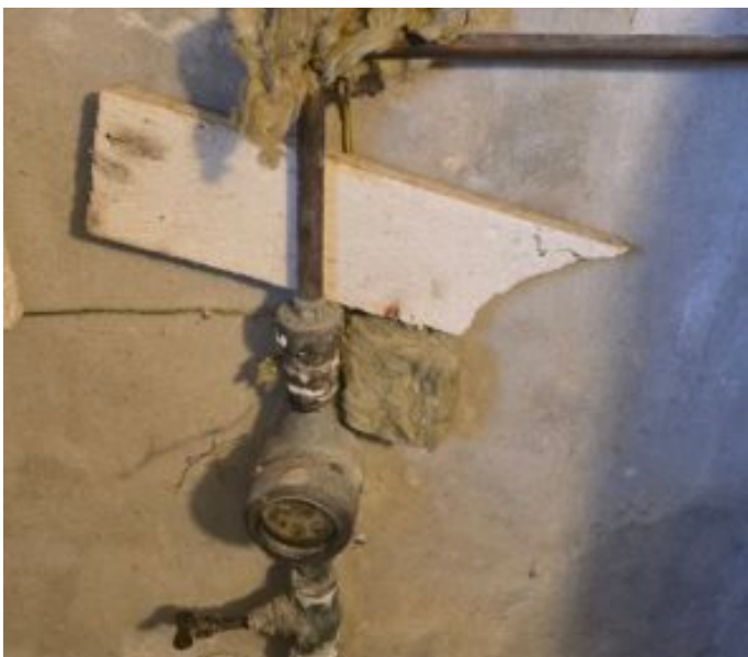
Bilde 1 Mangler utjevning til vannkraft.
