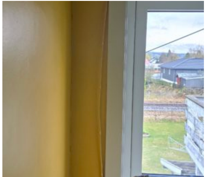
Bilde 2 Ledning løs på soverom.
