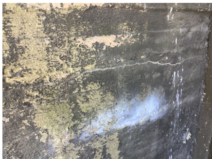
Eksempel på sprekk i støpt vange.
