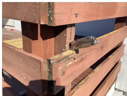
Råteskadet rekkverksstolpe og rekkverksbord i første etasje.
