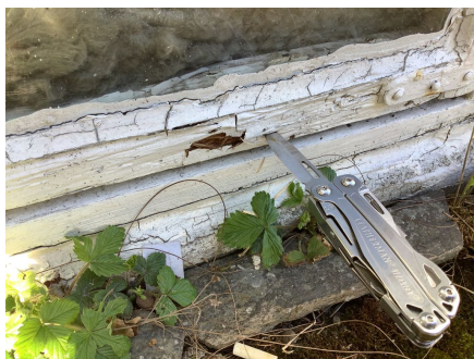
Værslitt kjellervindu med råteskader.
