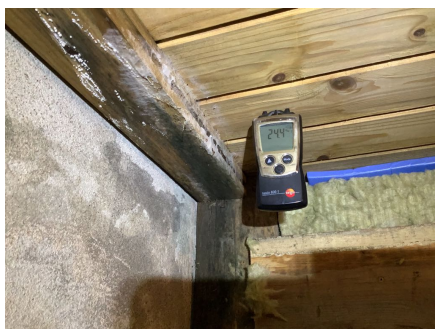
Det er sopp utvikling på hylle, og det måles skadelig fuktinnhold i himling.
