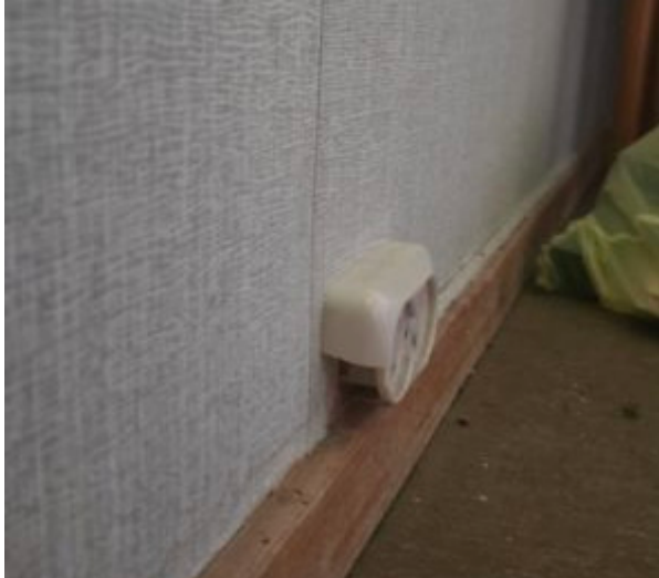
Bilde 1 Stikk har delvist knust lokk. Bør byttes. Soverom 1 etasje.
