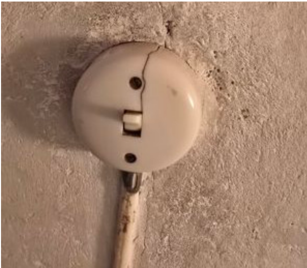
Bilde 1 Bryter defekt i trappenedgang. Bør byttes.
