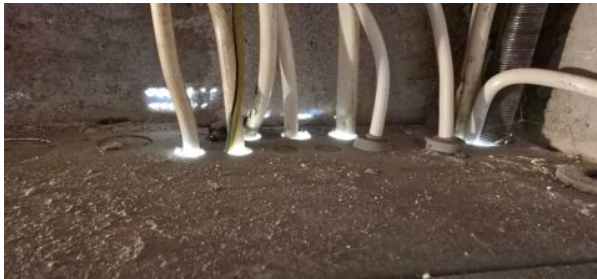
Bilde 1 Hull i tavle må merkes.
