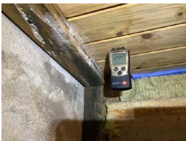
Det er sopputvikling på hylle, og det måles skadelig fuktinnhold i himling.
