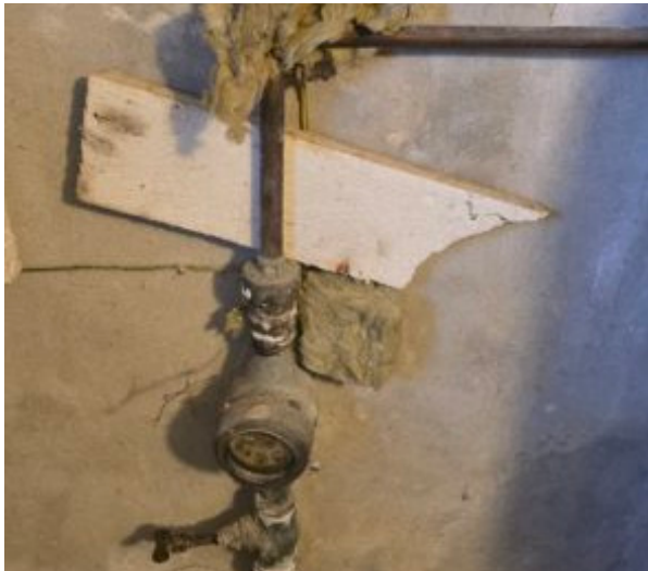
Bilde 1 Mangler utjevning til vannkraft.
