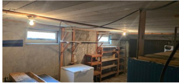
Bilde 2 Skjøteledning tvers over rom til fryseboks. Anbefalt å legge opp flere stikk.
