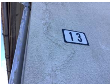
Eksempel på sprukket puss.
