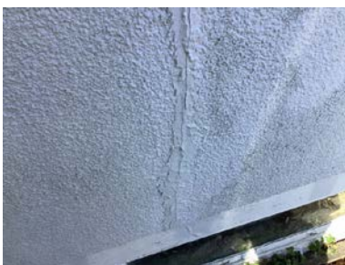
Eksempel på sprukket puss.
