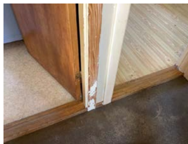
Slitasje på karmlist på dør.
