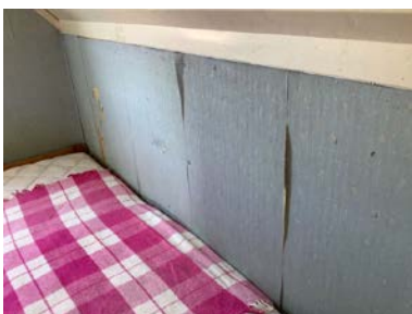
Løstnet tapet på soverom.
