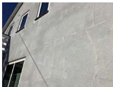
Eksempel på sprukket puss.
