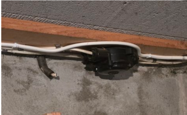
Bilde 1 Ledning fra tak ikke korrekt avsluttet. Kjeller.
