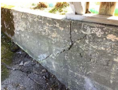
Eksempel på sprekk i støpt vange.
