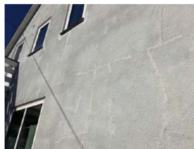
Eksempel på sprukket puss.
