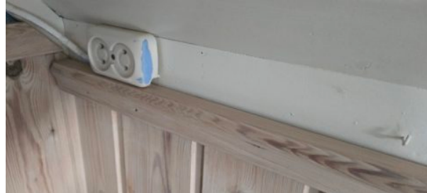
Bilde 2 Hull i lokk soverom 2 etasje.
