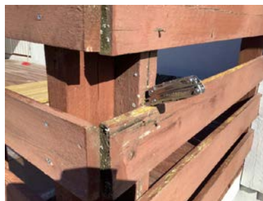
Råteskadet rekkverksstolpe og rekkverksbord i første etasje.
