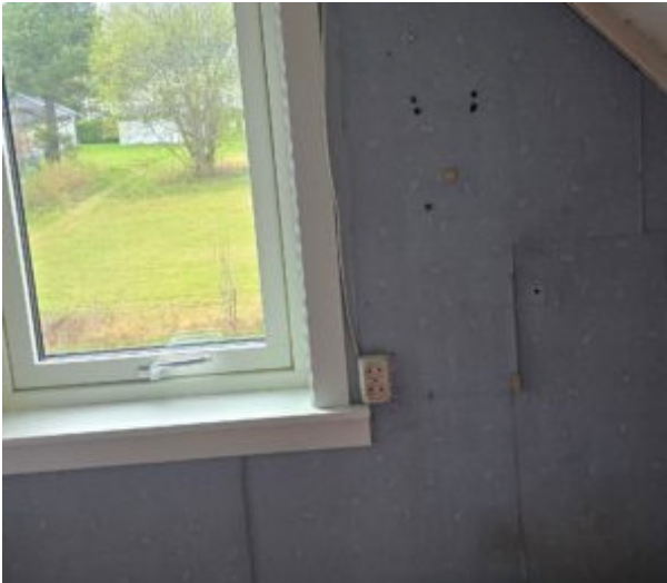
Bilde 3 Løs ledning
