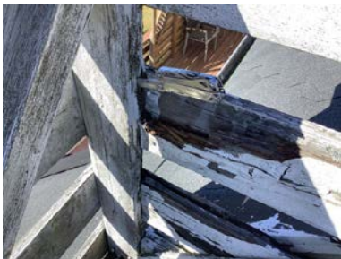
Råteskadet rekkverksstolpe og rekkverksbord på takterrasse.
