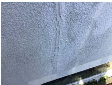
Eksempel på sprukket puss.
