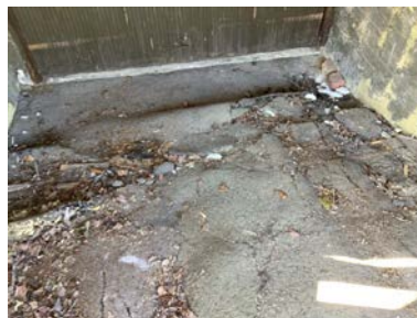
Ujevn asfalt med sprekkdannelser.
