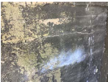
Eksempel på sprekk i støpt vange.
