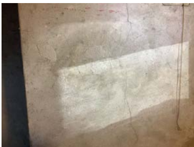
Svinnriss i pipe i kjeller.
