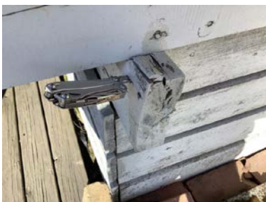
Råteskadet bærebjelke i første etasje.
