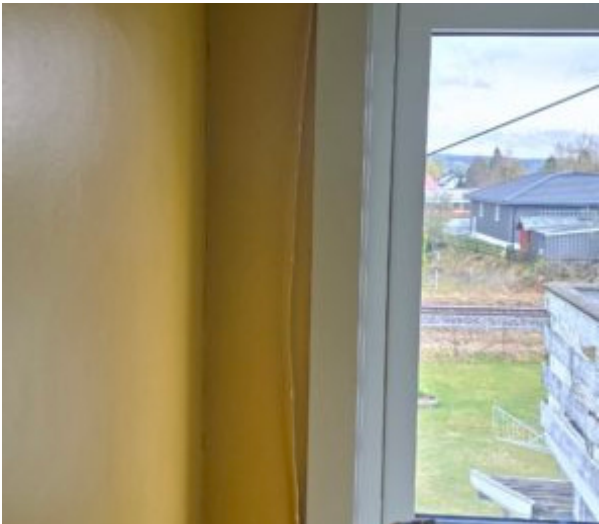
Bilde 2 Ledning løs på soverom.
