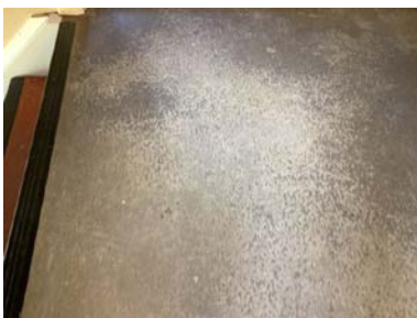
Slitasje på gulvbelegg.
