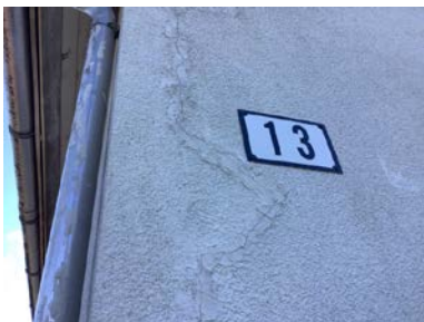
Eksempel på sprukket puss.
