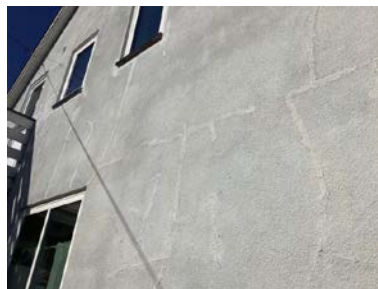
Eksempel på sprukket puss.
