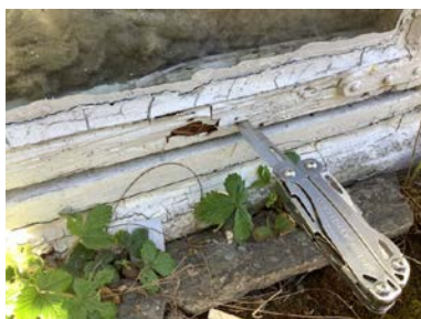
Værslitt kjellervindu med råteskader.
