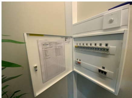
El-skap med automatsikringer.
