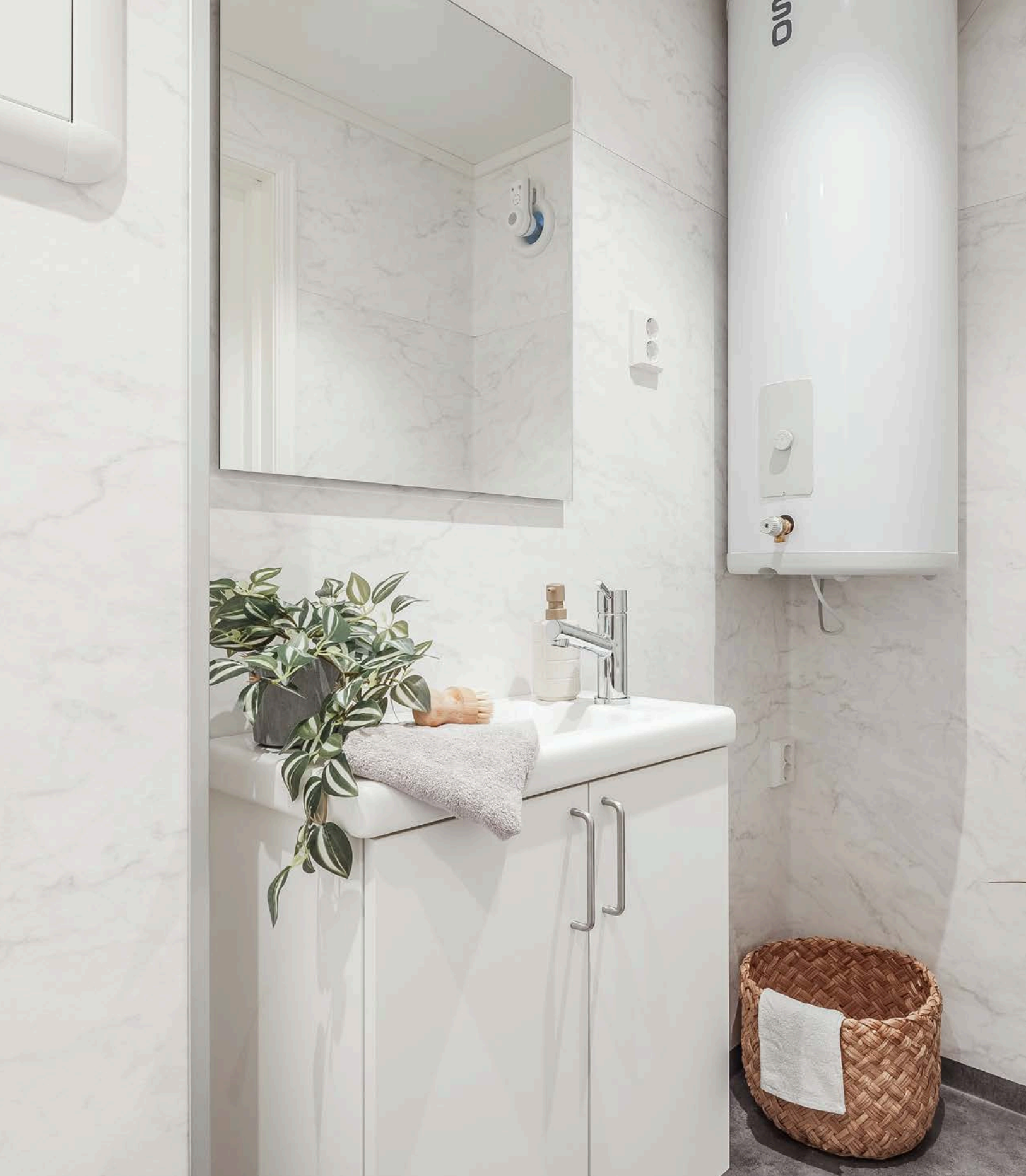
Nyrenovert bad. Gulvbelegg med varmekabler.
