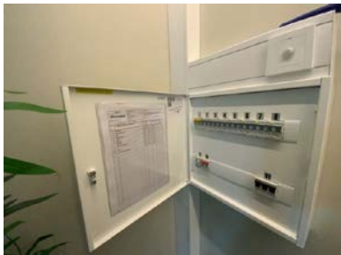
El-skap med automatsikringer.
