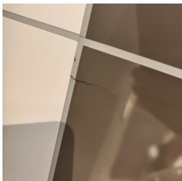
Bildet viser plate med en liten skade.
