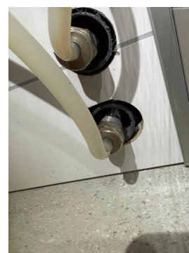
Bildet viser vannrør til dusjen med utette gjennomføringer.
